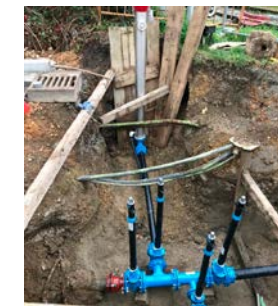
Hydrant mit Schiebergruppe (Quelle: Land Oberösterreich)
