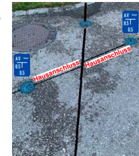
Hausanschluss (Quelle: Land Oberösterreich)
