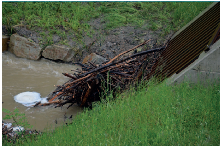
Abb. 6: Verklausung Rückhaltebecken Poneggenbach
