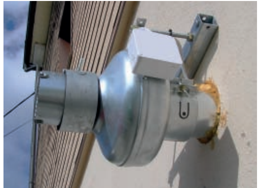
Ein außen liegender Ventilator erzeugt einen leichten Unterdruck unter der Bodenplatte.
