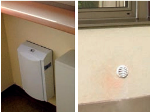
Kontrollierte Frischluftzufuhr erzeugt leichten Überdruck im Raum/Gebäude (innen und außen).
