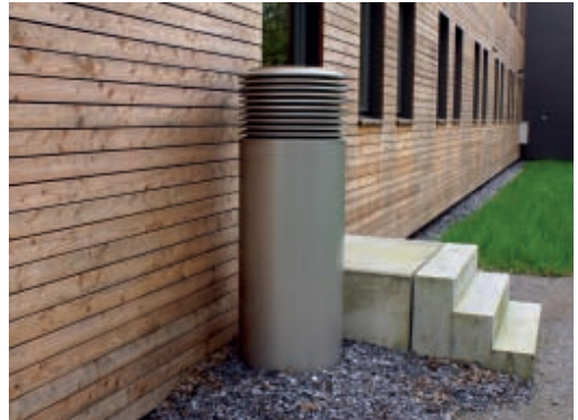
Ansaugöffnung für mechanische Zuluftanlage.
