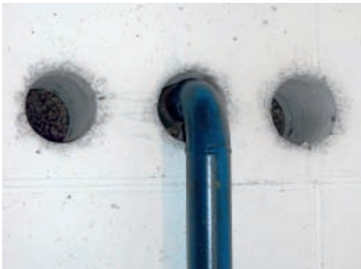
Größere Öffnungen und Risse in erdberührenden Bauteilen sind zu verschließen.
