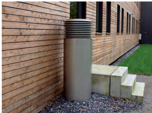
Ansaugöffnung für kontrollierte Wohnraumlüftung (mindestens 1,5 m über Boden)
