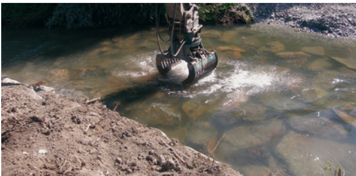
Abb. 153: Nachbettung, Abflusskonzentration im Außenbogen, Herbst 2006
