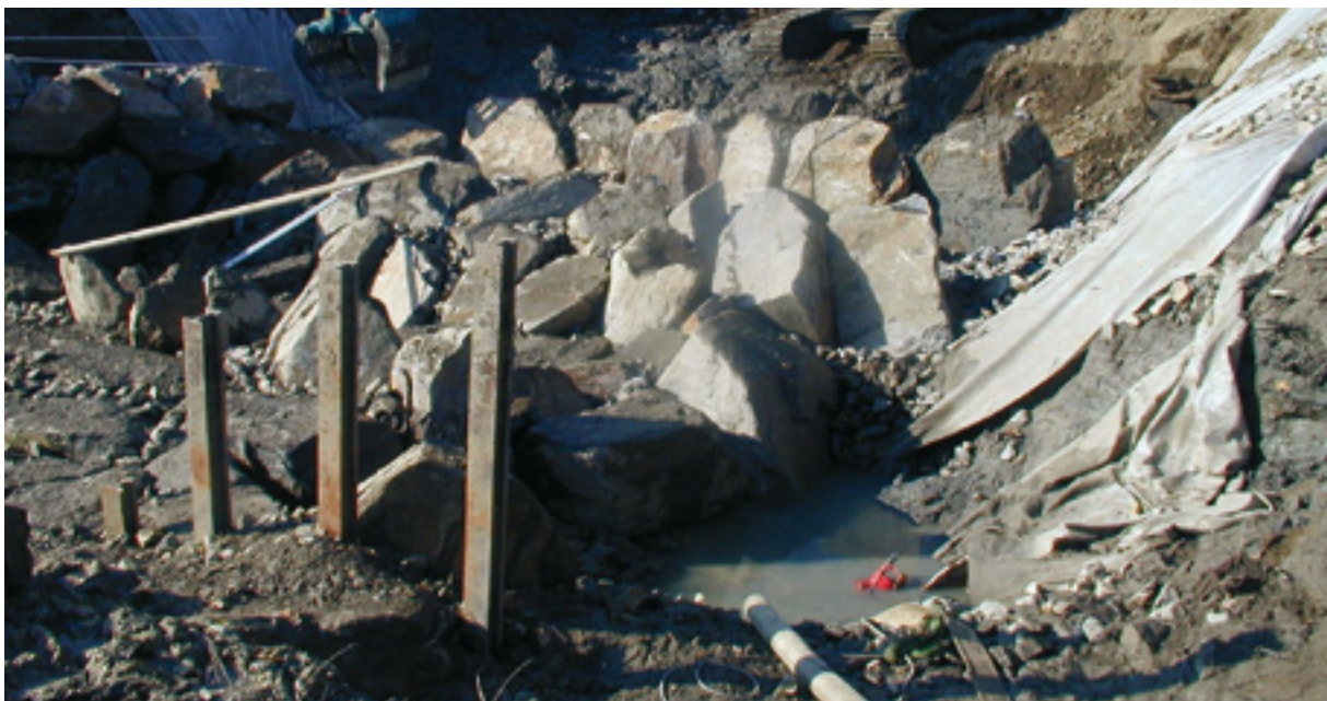
Abb. 51: Bauvlies unter Filterschicht
