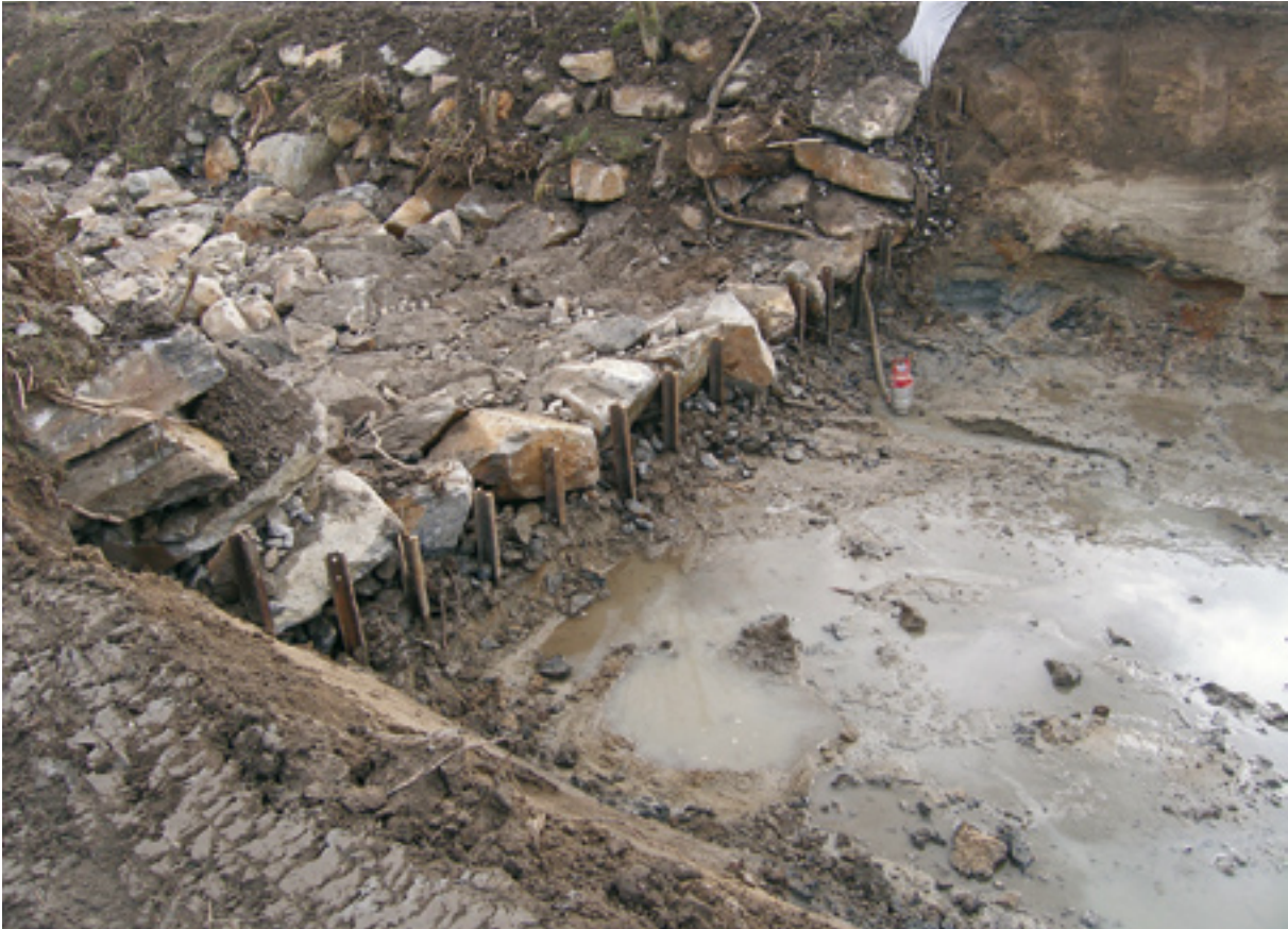
Abb. 97: Schienenkäfig zur mechanischen Sicherung
