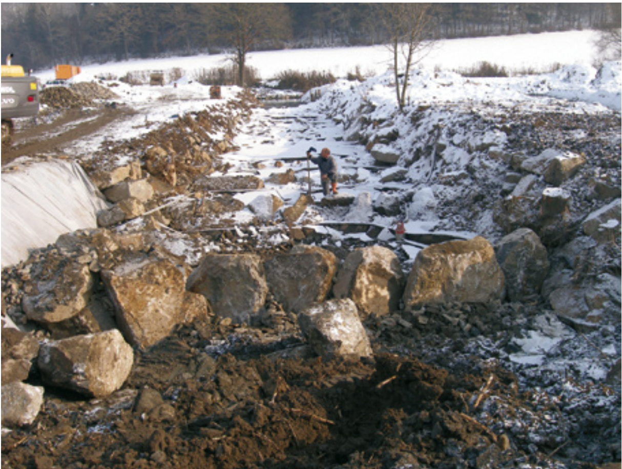
Abb. 100: Riegelformation, Absturzhöhe ansteigend von 0,2 m auf 0,3 m
