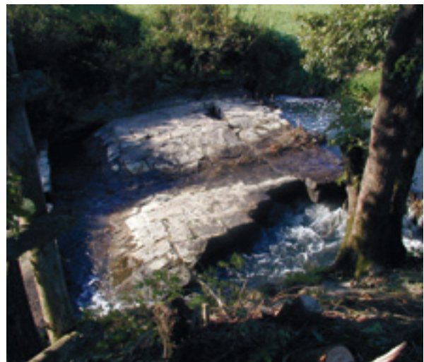
Abb. 44: Detail: beschädigtes und unterspültes Wehrfeld
