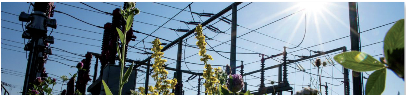
Umspannwerk und Naturwiese
