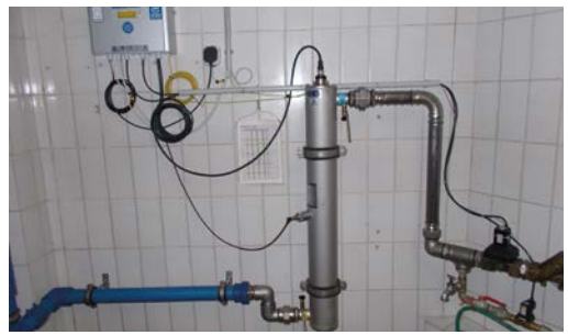
Beispiel einer UV-Desinfektionsanlage
