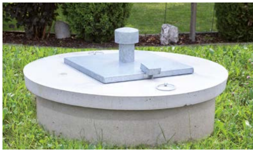
Brunnenvorschacht mit Schachtdeckel und Entlüftungshut
