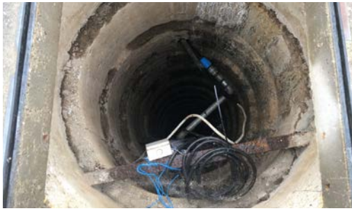
Mangelhafter Schachtbrunnen durch undichte Schachtringe
