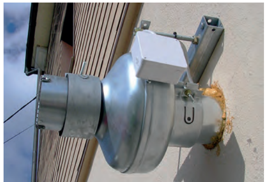
Ein außen liegender Ventilator erzeugt einen leichten Unterdruck unter der Bodenplatte.
