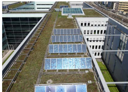
Abbildung 11: Naturaufnahme Photovoltaikanlage und thermische Solaranlage - Quelle: Land OÖ
