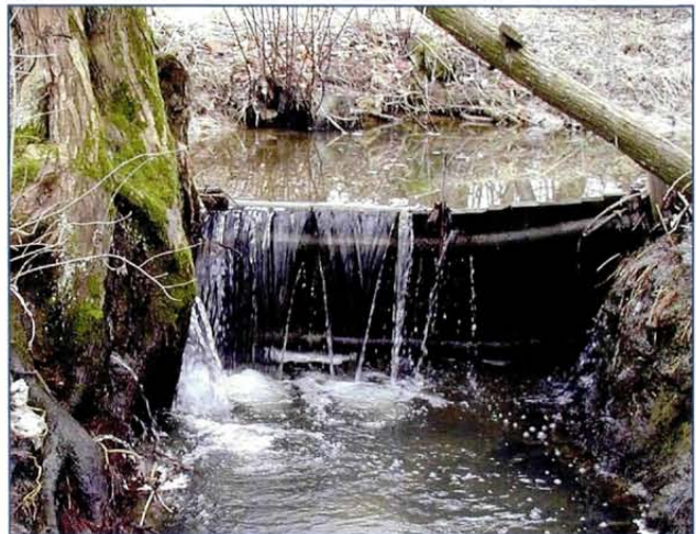
Abb. 5: Ein abgelöster Wasserstrahl ist für die aquatische Fauna nicht durchwanderbar.
