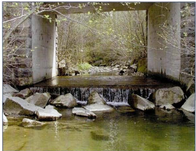
Abb. 8: Dieses Querbauwerk verfügt über eine ganze Reihe konstruktiver Merkmale (siehe Text), die die Passierbarkeit verhindern.
