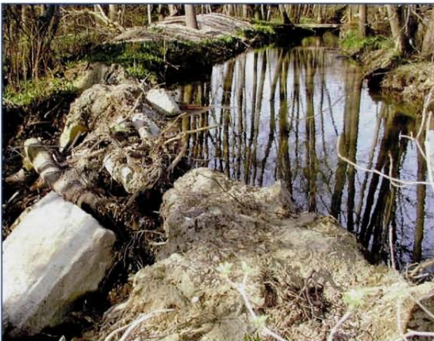
Abb. 79: Das Querbauwerk Nr. 4-4 im Piberbach wurde beim letzten Hochwasser massiv beschädigt
