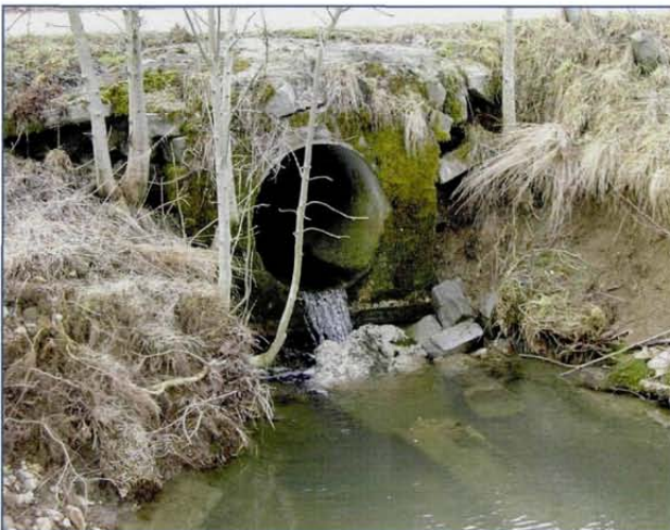
Abb. 27: Für Makrozoobenthos und flussaufwärts wandernde Fische infolge des abgelösten Überfalls unüberwindbarer Rohrdurchlass.
