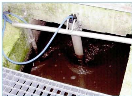
Abb 5: Durchflussmessung für Rücklaufschlamm mit Doppler Ultraschall Prinzip
