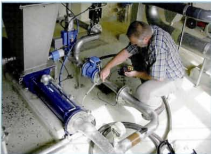
Abb 2: Magnetisch Induktive Durchflussmesser (MID) der Schlammbehandlung - "Müse"
