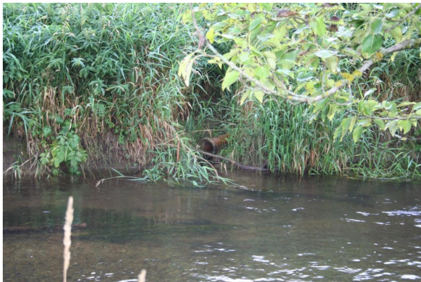
Abb. 5: Drainageeinleitung als Problem für die Wasserqualität der Gewässer. (Foto: B. Thurner)
