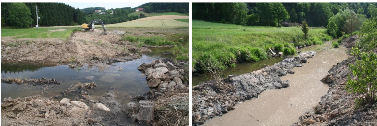
Abbildung 29 Die Baumaßnahmen im Unterlauf des Sandbachs (links) und dadurch hervorgerufene Trübung im Gewässer (rechts) machten eine Muschelbergung in diesem Abschnitt notwendig.
