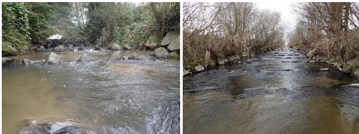
Abbildung 30: Teilpassierbare Mündungsrampen des Sandbaches (links) und des Leitenbachs (rechts) in die Aschach.
