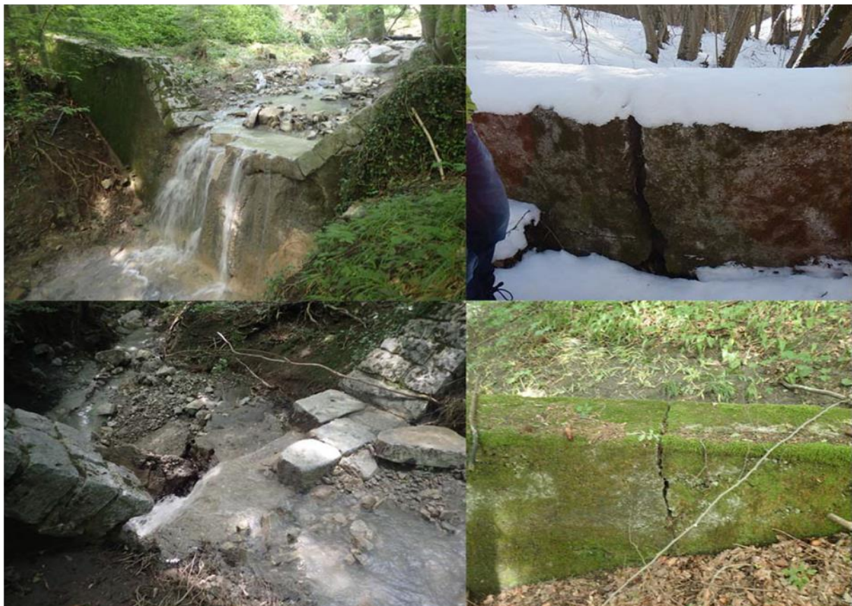
Stark beschädigte Konsolidierungssperren, bei denen die Abflusssektionen (Bild links) sowie die Sperrenflügel zerstört wurden.
