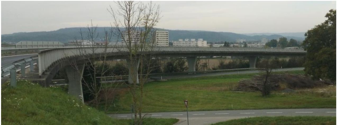
Abb. 4: Bestandsaufnahme 'Große Heinrichbrücke' Quelle: Land OÖ
