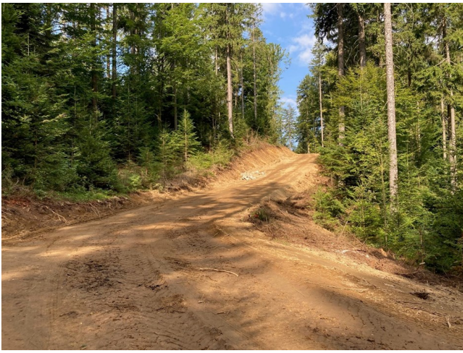
Forststraßenprojekt Mitternschlag in Atzesberg, Rohtrasse vor Aufbringung der Befestigung mit Granitschotter, Fertigstellung September 2023 Foto: BH Rohrbach
