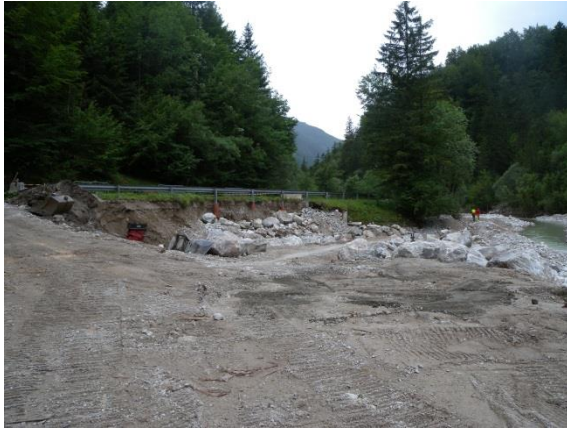
Abbildung 132: ~hm 8,5, Beschädigung der Straße
