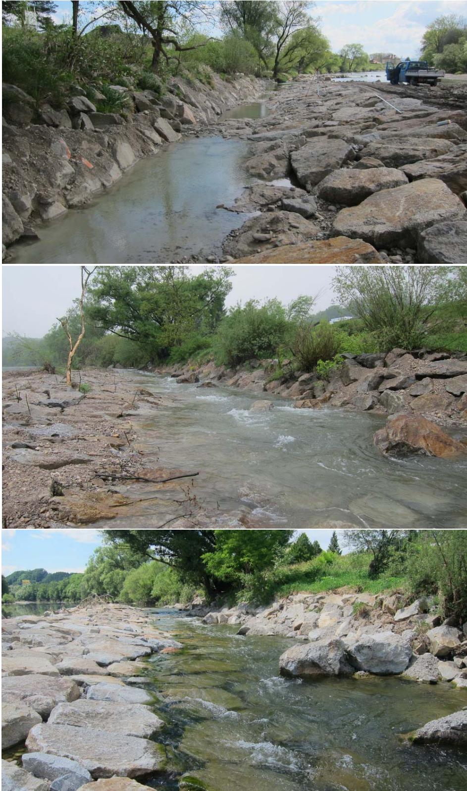
Abbildung 46: Beispiel für asymmetrische Rampe mit Teilabfluss in vollem Hochwasserabflussbereich an der Ybbs/Amstetten (Gefälle 1,6%); oben: Rohplanum mit Kolk-Furt-Abfolgen im Bauzustand ohne Kurzbuhnen; Mitte: nach grober Positionierung der Kurzbuhnen im Bauzustand (aktuelles Q \sim 1,2 \text{ m}^3/\text{s} ); unten: nach Durchgang eines 22-jährigen Hochwasserereignisses (aktuelles Q \sim 0,9 \text{ m}^3/\text{s} )
