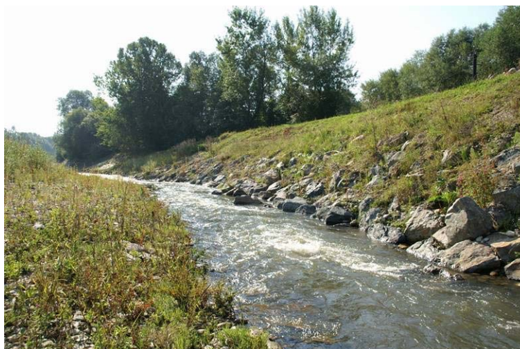
Abbildung 42: Asymmetrisches Raugerinne im Hochwasserabflussbereich mit Sohle aus Wasserbausteinen und Kies am Beispiel der Gamlitzbach-Mündungsrampe (ZAUNER ET AL., 2009).
