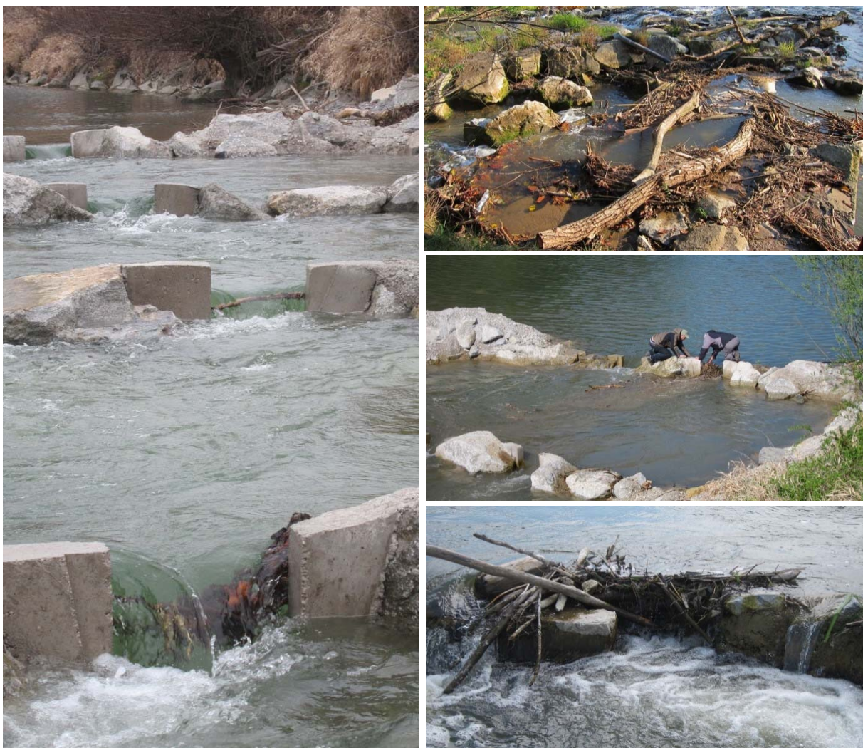
Abbildung 48: Beispiele für Verklausungsproblematik an Beckenpässen
