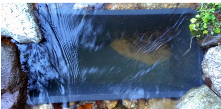
Abbildung 278: Feststoffe in der Geschiebefalle 2 am 16.01.2015
