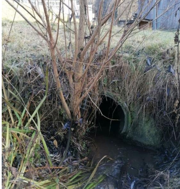
Abbildung 26: Einlauf des 60 m langen Durchlasses (Foto: Vermessung Hainzl & Partner)
