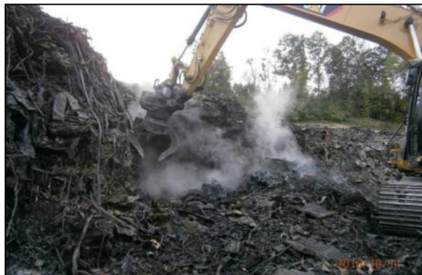
Abb. 3: Freilegen eines Hot-Spots mit Brandgefahr (Oktober 2016)
