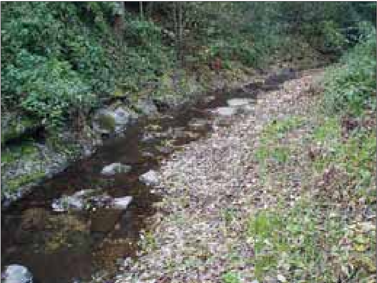
Abb. 42: Blockwurfsicherung im Nonsbach
