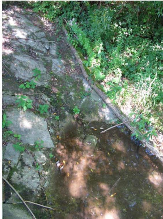
Abb. 7: Teilweise befestigte Böschung und Flusssohle im Auenbereich (Foto: REGI-OPLAN INGENIEURE Salzburg GmbH)
