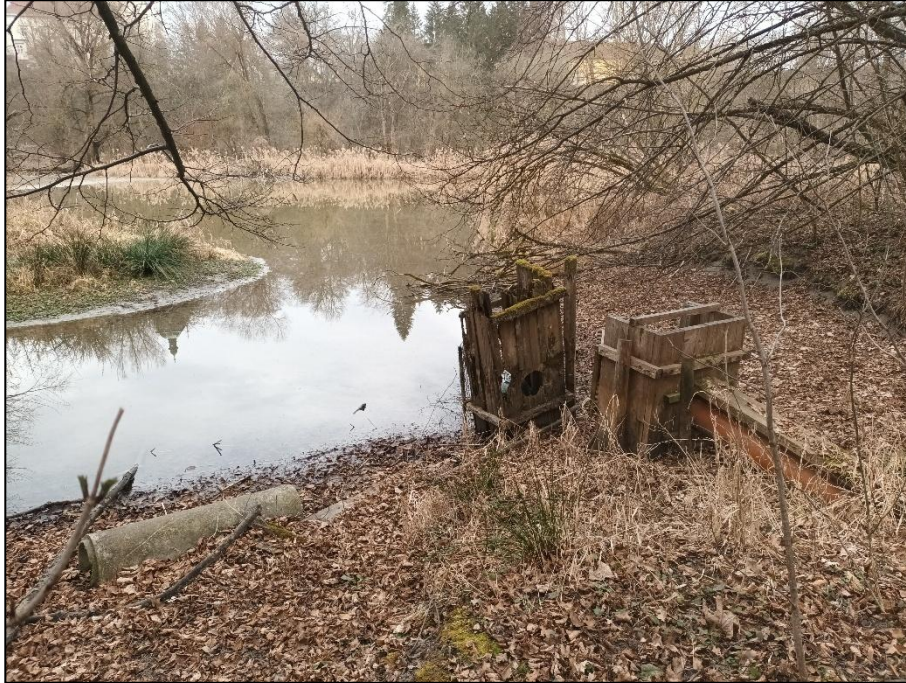
Abb. 4 Der letzte noch sanierungsbedürftige Mönch in Teich Nr. 4. Bild vom 10. März 2025.
