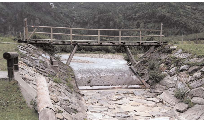
Unzureichendes Abflussverhalten durch Wasser- ausleitungen.
