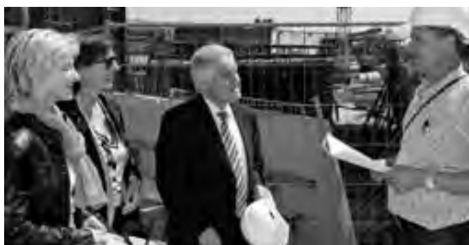
Bauleiter Ing. Siegfried Humenberger informiert LH Dr. Josef Pühringer, Rektorin Univ.-Prof. in Dr. in Marianne Betz und Universitätsdirektorin Mag. a Brigitte Mössenböck über die Fortschritte auf der Baustelle.
