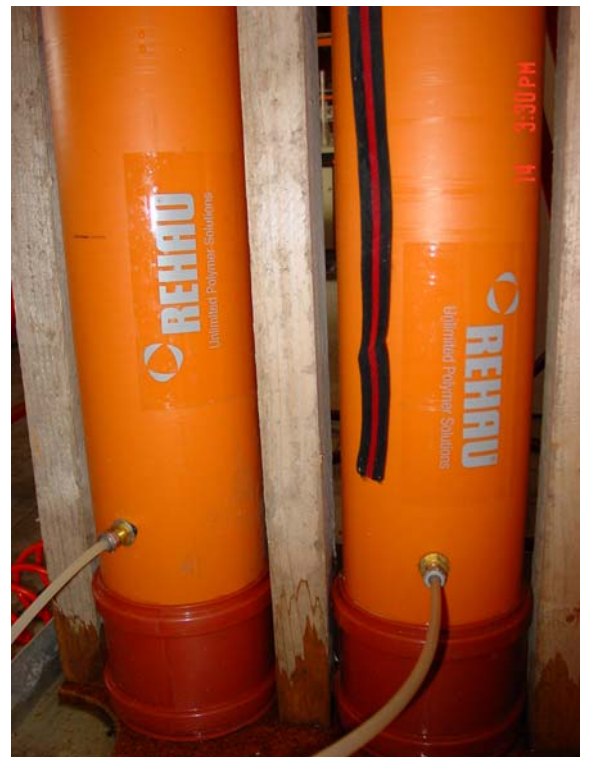
Abbildung 8, Wasserzufluß am unteren Rohrende
