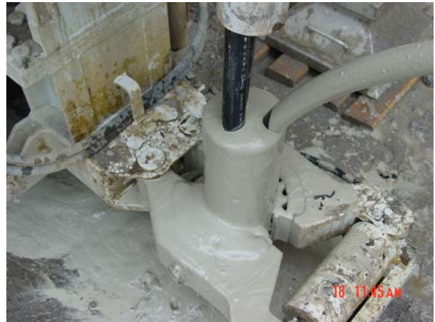
Abbildung 8, Austreten der Suspension am Bohrlochmund
